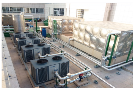
(a) 协和医院空气源热泵热水项目
