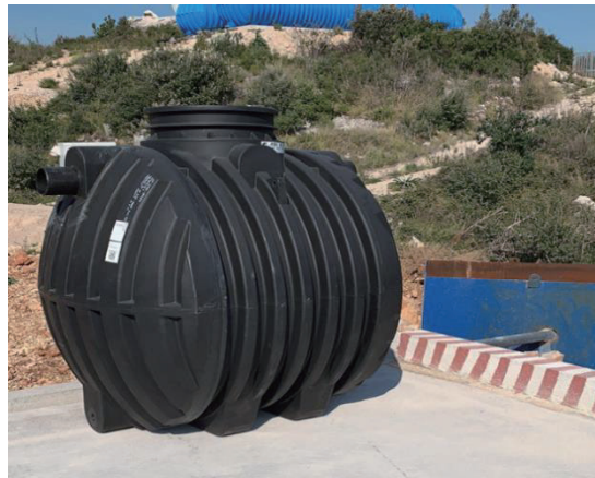
图 40 混凝土罐车停放区设置油水分离器
