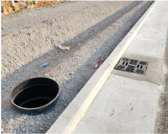
(a) 沿路基布置的集水井和检查井
